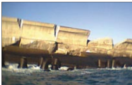
Pormenor da destruição do muro de cortina
