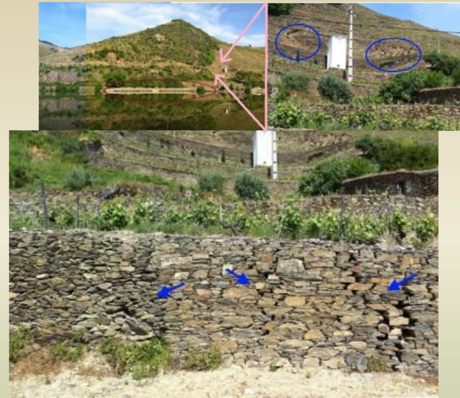
Aspecto parcial do cais de Sabrosa, escorregamentos na encosta a montante da localização da rotura no muro de gabiões
